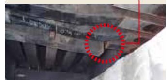
下面から見た伸縮装置の破断状況
